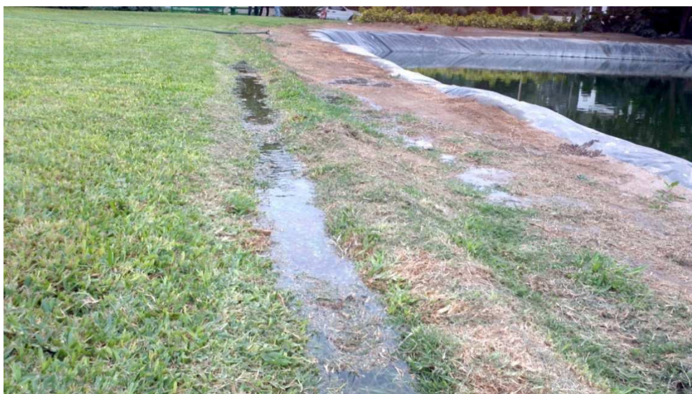
Figura N° 42: Acumulación de agua en la parte más baja en el área de césped
