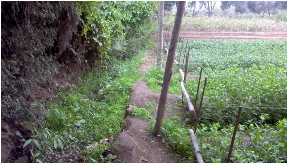
Figura N° 39: Canal de conducción sin revestir y con presencia de material grueso
