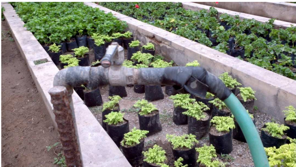
Figura N° 40: Conexión de punto de agua a manguera en el área de plantas de sol
