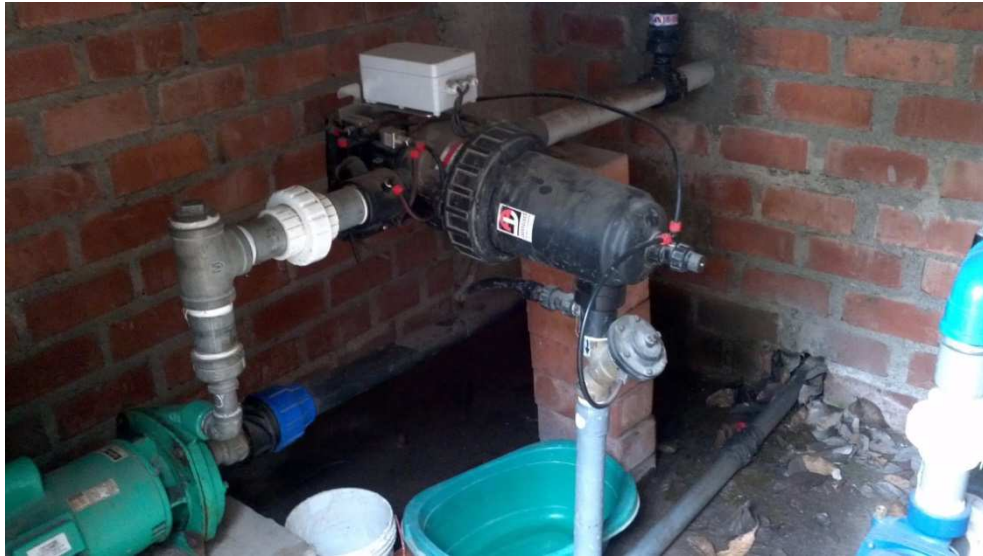
Figura N° 43: Equipo de bombeo y recolección del agua de las fugas
