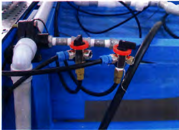
Foto N° 13: Control de mandos hidráulicos
