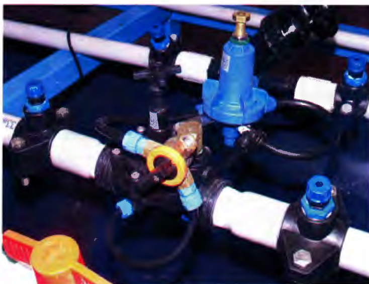
Foto N° 09: Válvula hidráulica con piloto sostenedor de presión.
