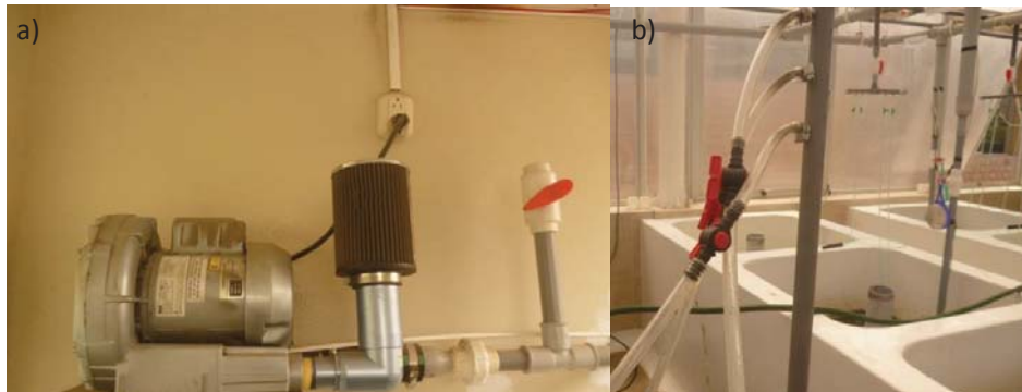
Figura 19: (a) Bomba de aire y (b) manguerillas y válvulas, empleadas en el sistema de aireación.
