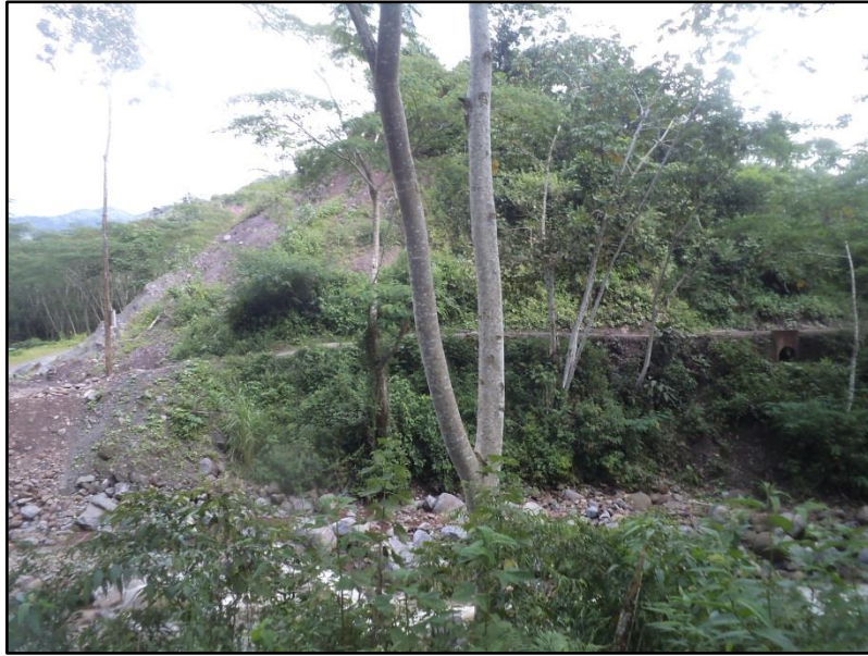
Figura 33: Fotografía de del estado de la margen derecha del río Chunchumas
