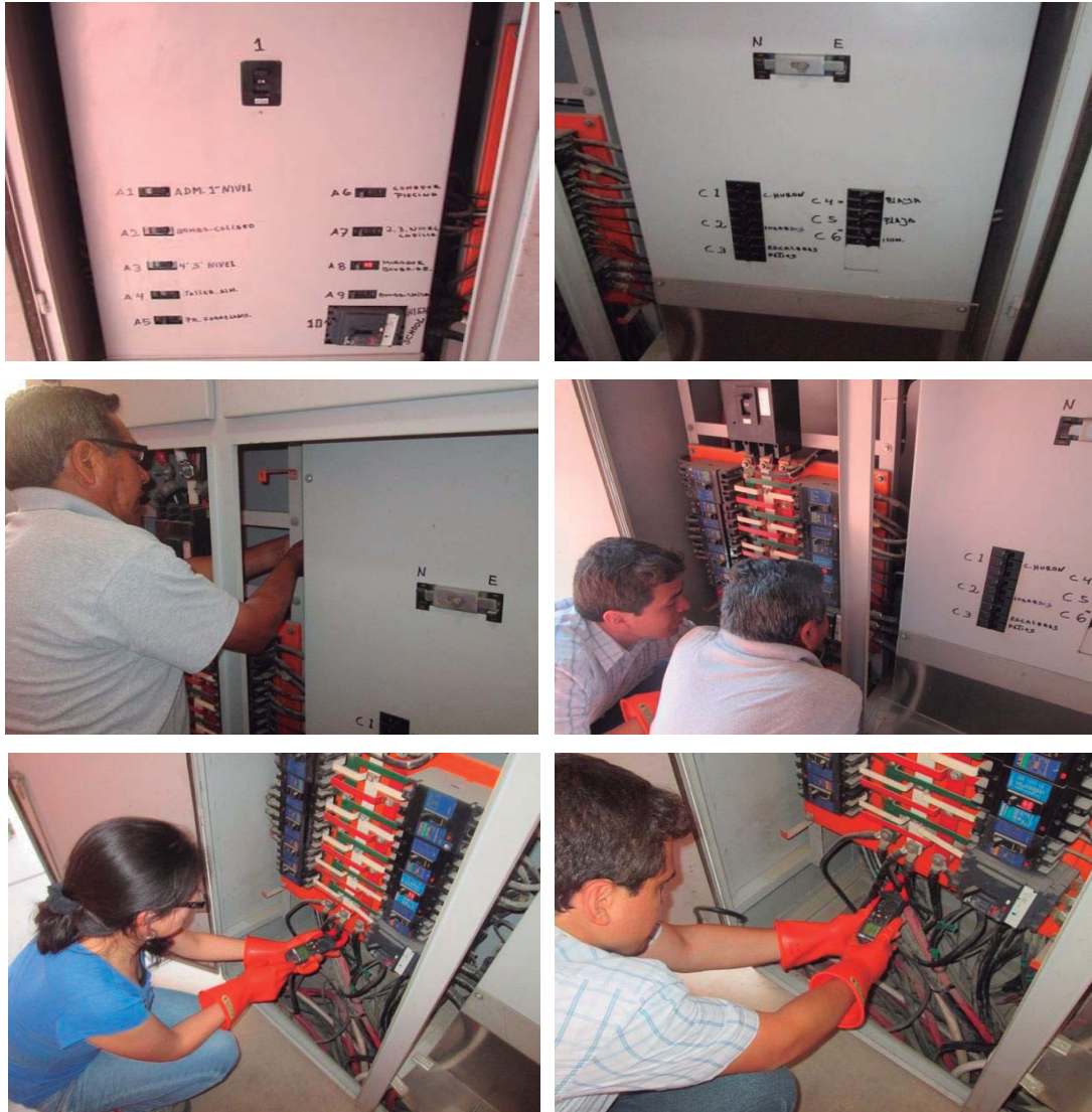
Figura 26: Monitoreo en el Tablero General ubicado en la Sub – Estación Principal del Colegio Villa Caritas.
