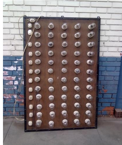
Foto 6: Tablero de carga eléctrica
