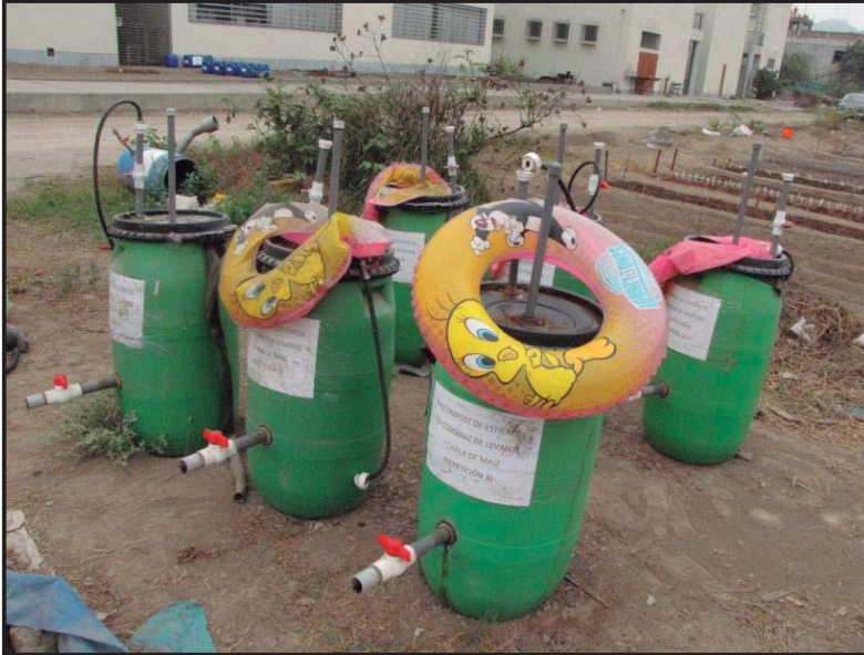
Fotografía 16. Vista de los 6 biodigestores
