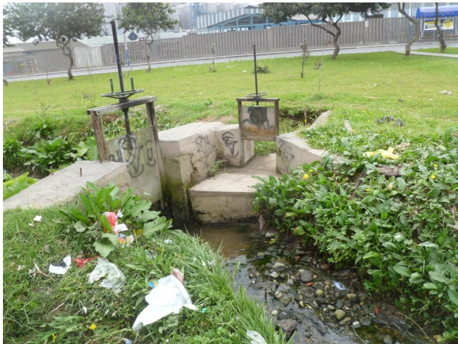
Fotografía 10.-Presencia de compuertas múltiples en el canal Cruce de la Av. Separadora Industrial y Calle Almanza
