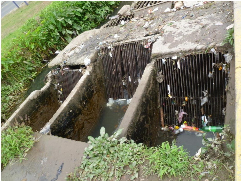
Fotografía 4.- Sistema de rejas sin mantenimiento Av. Prolongación Javier Prado, a la altura del Estadio Monumental
