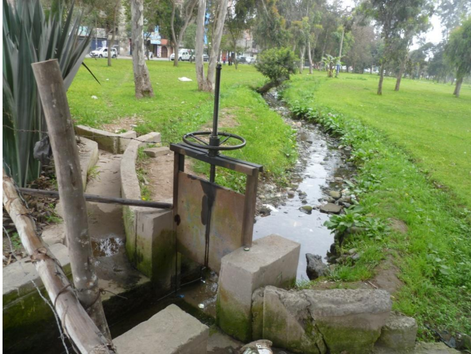
Fotografía 11.-Presencia de vegetación que ocasiona la pérdida de la sección del canal Av. Separadora Industrial, desde el Óvalo de Mayorazgo hasta la Av. Huarochirí
