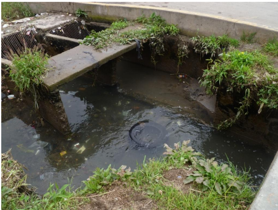
Fotografía 2.- Presencia de residuos sólidos en el canal. Av. Prolongación Javier Prado, a la altura del Estadio Monumental
