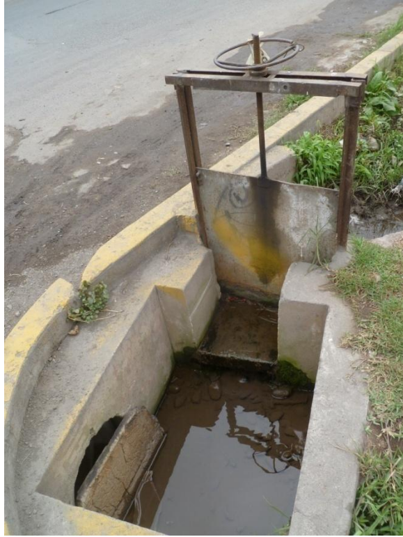
Fotografía 3.- Compuerta del canal en mal estado Av. Prolongación Javier Prado, a la altura del Estadio Monumental
