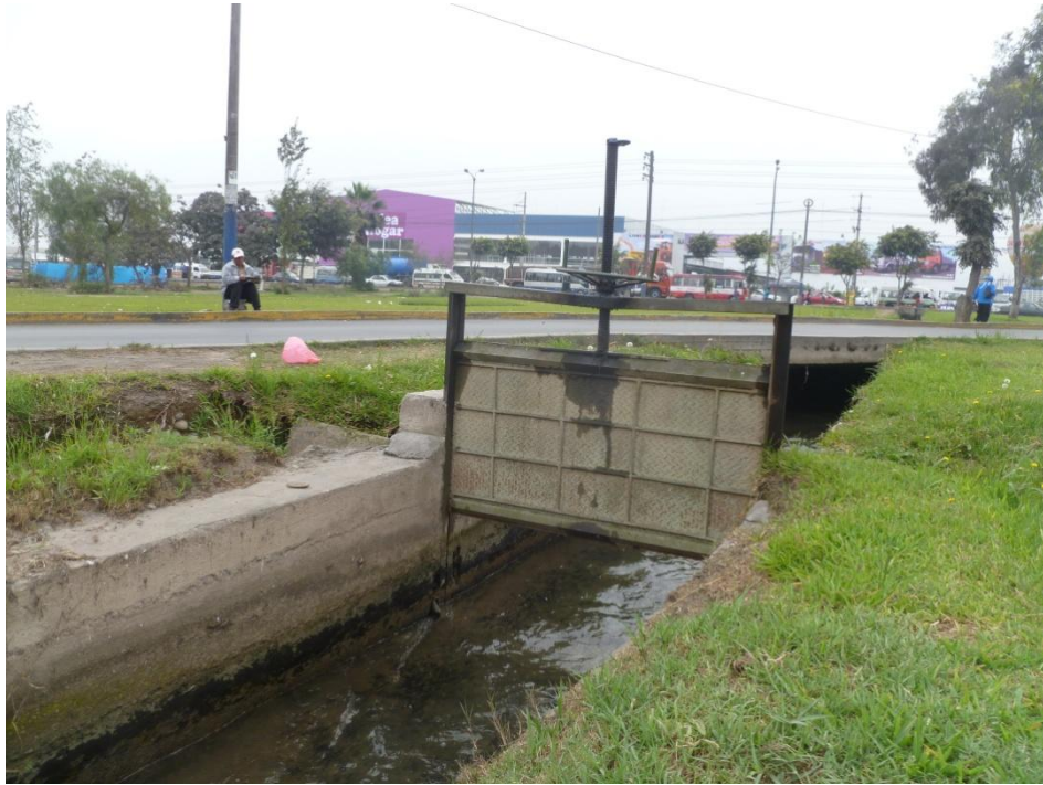
Fotografía 9.-Compuerta en el canal Av. Separadora Industrial, frente a la empresa Backus
