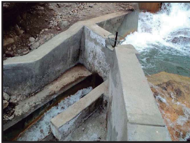
Fotografía 31: Captación en el río Quiula del canal de Acobamba (Distrito de Laraos)
