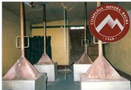
Sistemas de calefacción
