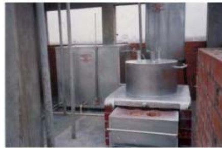
Sistema de Calentamiento de Agua
