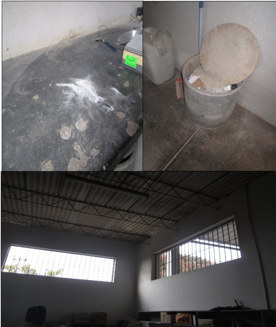
Foto 19: Generación polvo y material particulado en exceso
