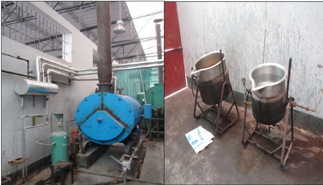
Foto 6: Caldero de la planta de alimentos, cuyo funcionamiento es a energía eléctrica
