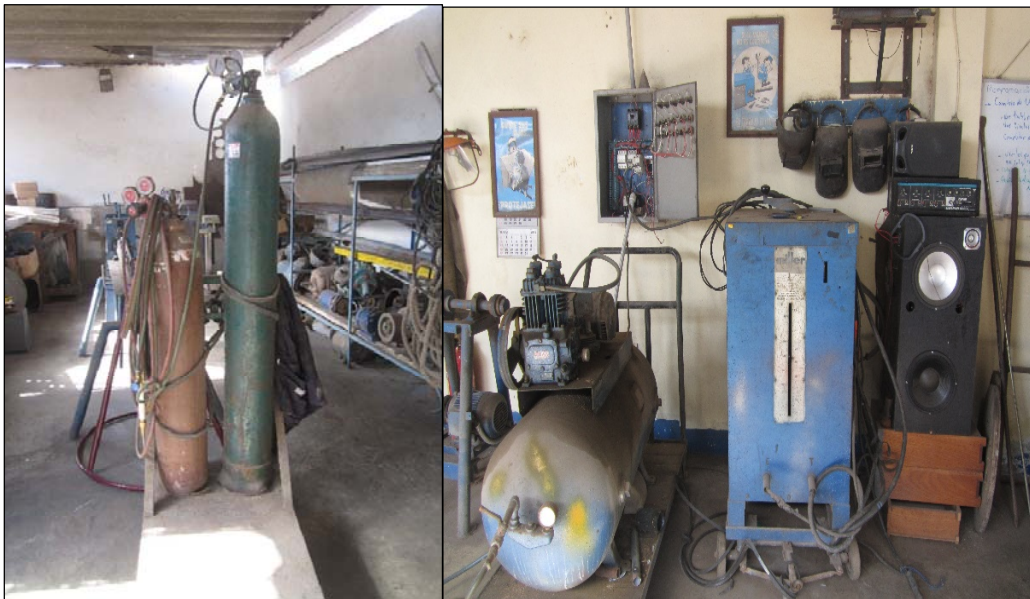
Foto 3: Máquina de soldar autógena, para el mantenimiento de piezas o equipos de la planta
