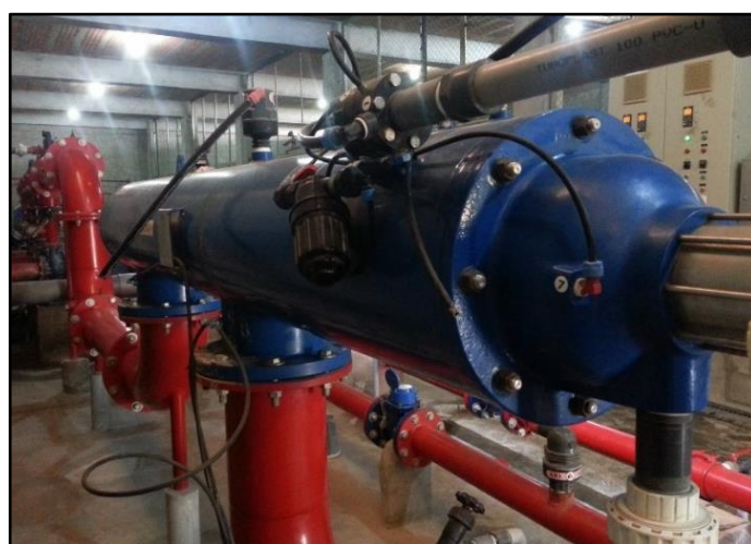
Figura 5: Sistema de filtro de malla existente en campo de riego Carmin.
