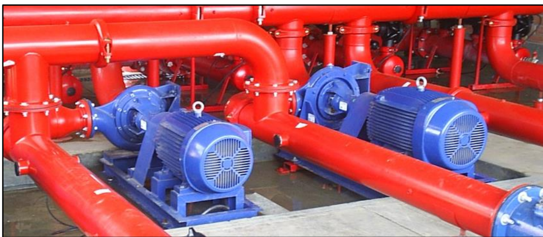
Figura 4: Sistema de bombeo existente.
