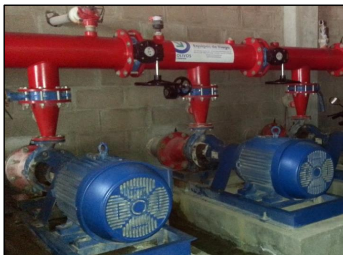
Figura 34: Bombas en paralelo marca Hidrostal del sistema Carmín.
