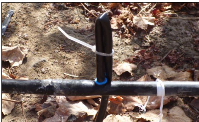
Figura 27: Emisor evaluado en campo para poder determinar la presión de trabajo, este debió ser señalado con el fin de encontrarlo fácilmente cuando se lleve a cabo la segunda evaluación del sistema. Abril, 2014.
