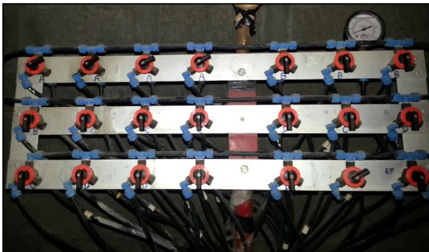
Figura 36: Tablero de comando de la automatización del campo de riego.
