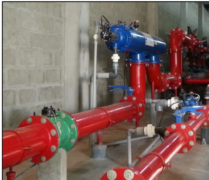
Figura 35: Ubicación de medidor de caudal en campo Carmin.
