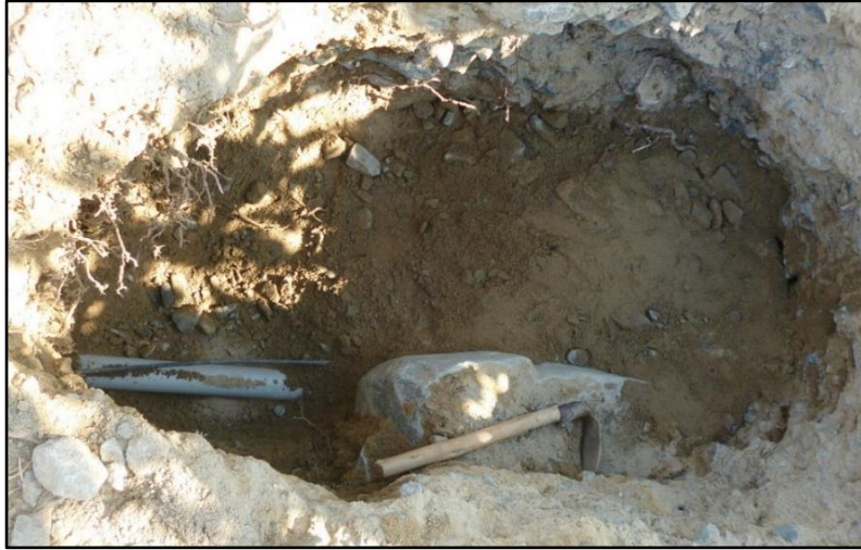
Figura 42: Calicata realizada en campo para verificar el recorrido de microtubos y así poder generar el plano de automatización no existente.
