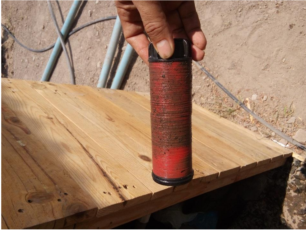
Figura 117: Limpieza de filtros
