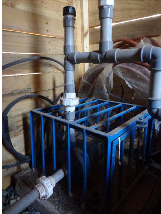
Figura 85: Canastilla de seguridad de la bomba, anclada a una losa
