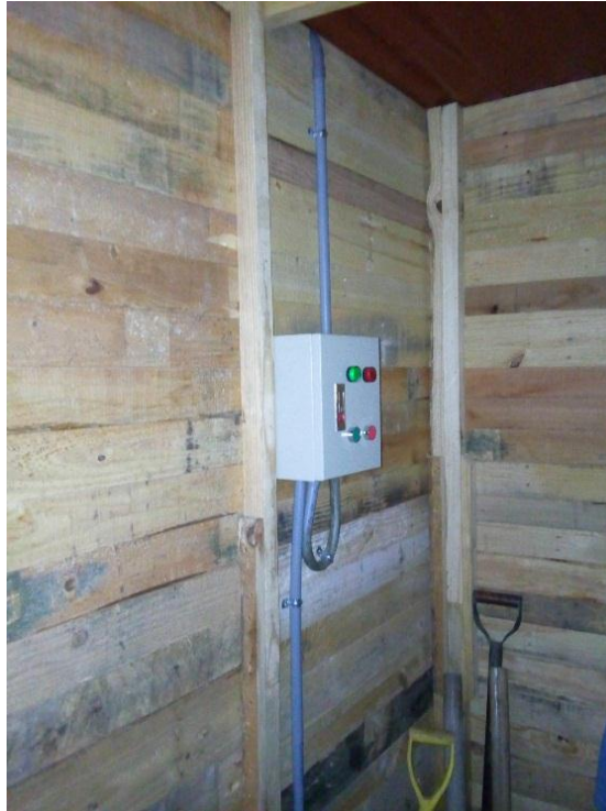
Figura 83: Tablero de control eléctrico
