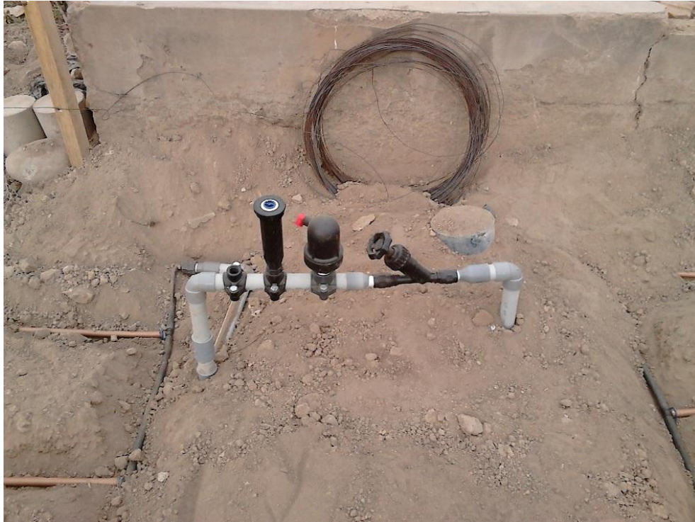
Figura 79: Arcos de riego cascos de protección de válvulas volumétricas
