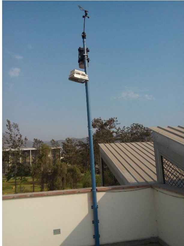
Figura 103: Estación meteorológica Davis instalada
