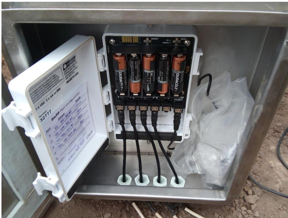
Figura 96: Interior del Data logger
