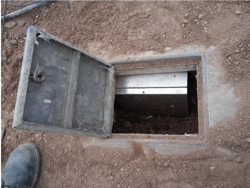
Figura 97: Caja de registro sobre la caja de seguridad del Data logger
