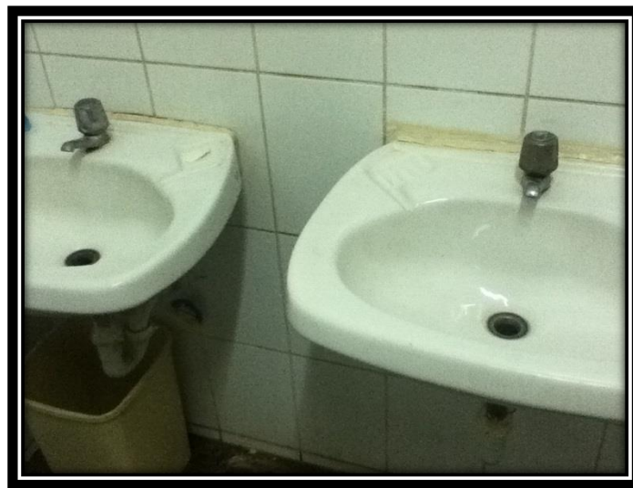
Figura 11: Lavaderos de los baños del comedor universitario
