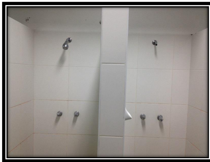
Figura 13: Duchas de los baños del comedor universitario
