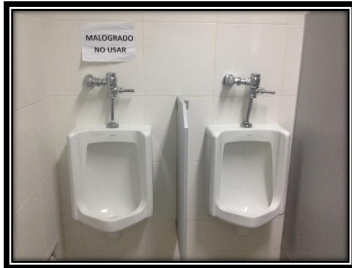
Figura 12: Urinarios de los baños del comedor universitario
