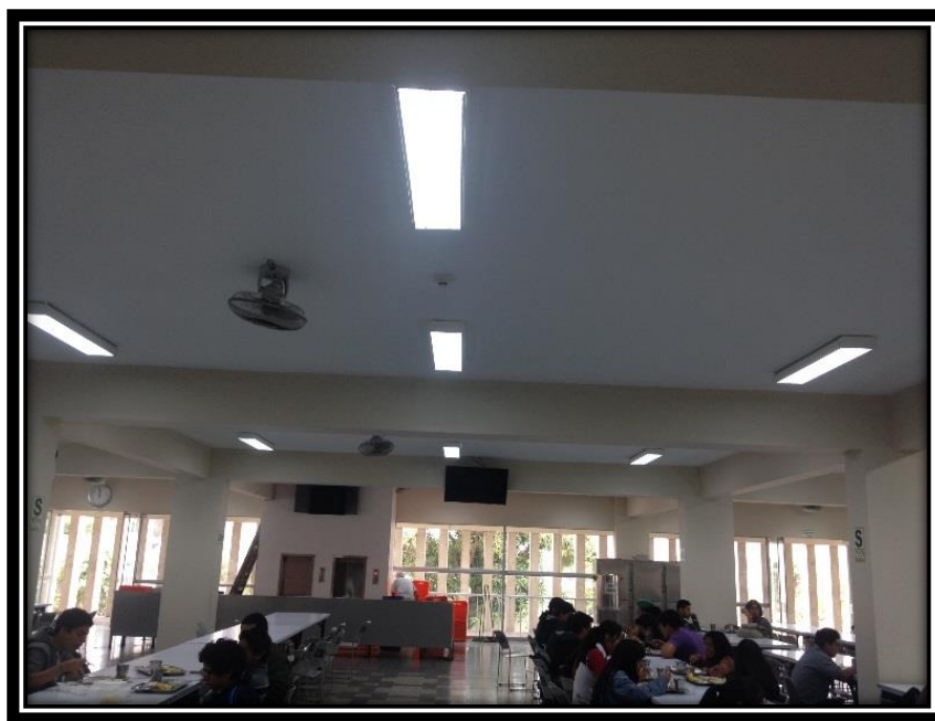
Figura 15: Equipos fluorescentes del comedor universitario
