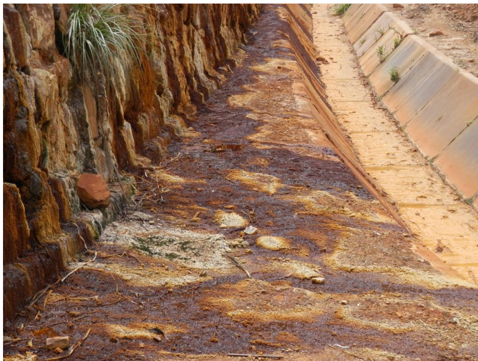
Figura 20: Canal de derivación colapsado
