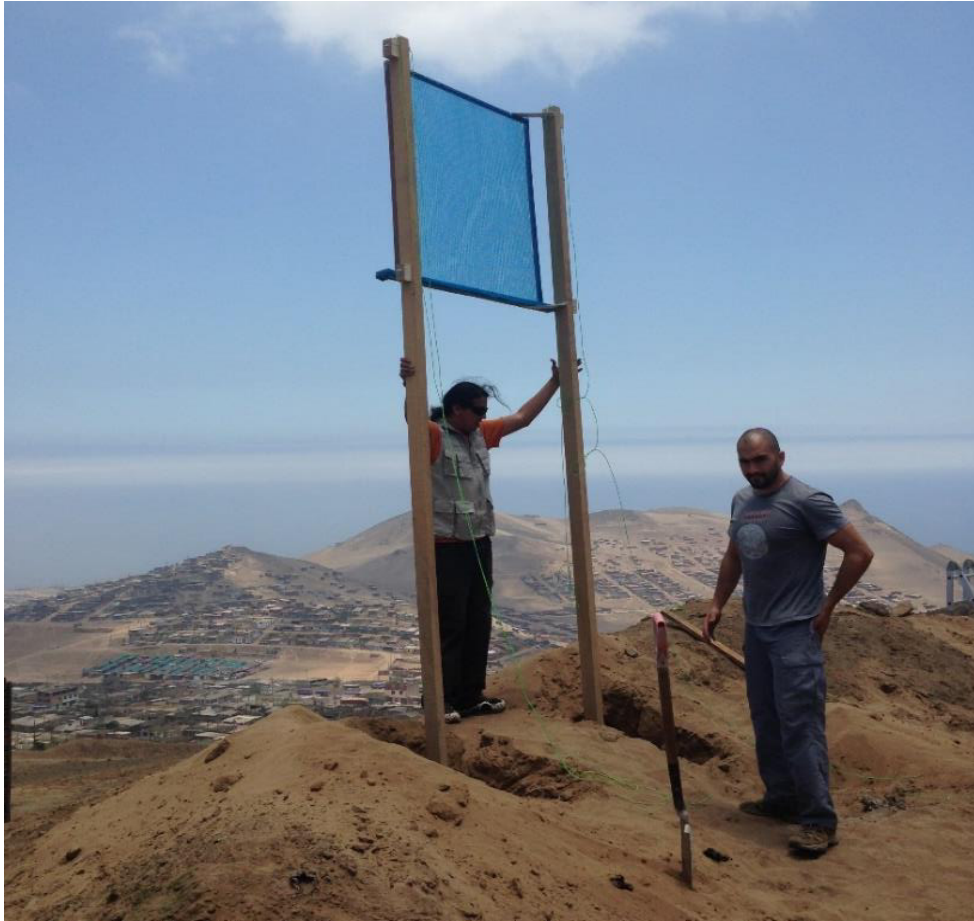
Figura 30: Instalación del neblinómetro SFC en la zona de estudio
