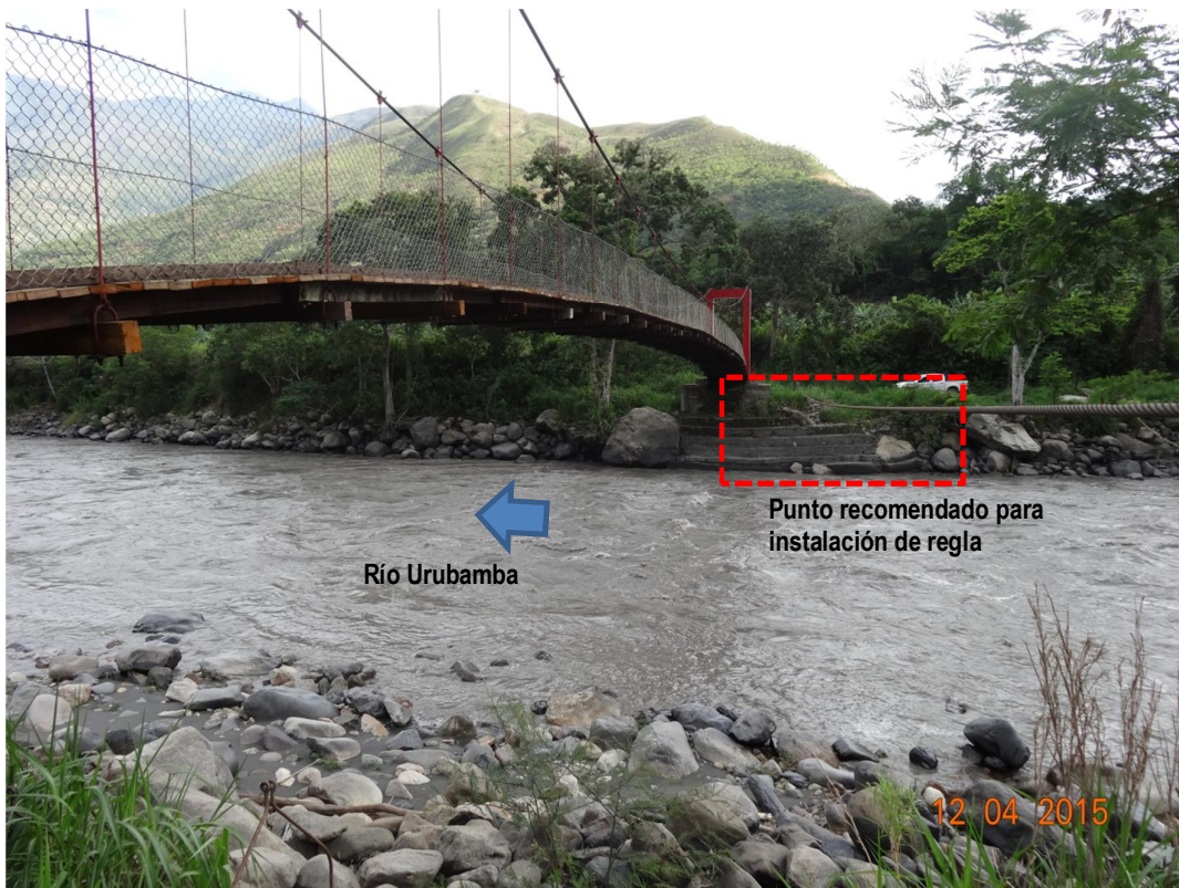
Figura 24 ó Recomendación para ubicación de Regla RL-05 en base de estribo de puente
