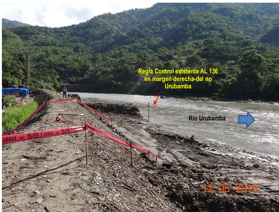
Figura 34 ó Defensas ribereñas en margen derecha del río Urubamba, para campamento AL-136
