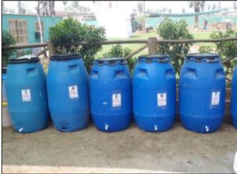
Figura 23: Batería de biodigestores
