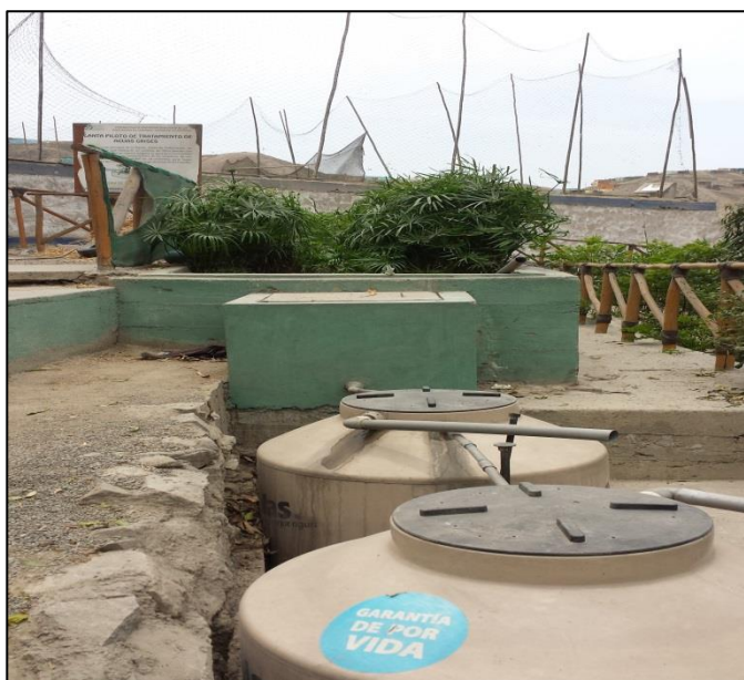
Anexo 1.13: Vista de zona de salida, se aprecia la distribución del humedal y los tanques de almacenamiento.
