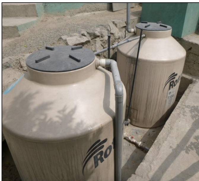
Anexo 1.15: Tanques de almacenamiento de agua gris tratada, cada uno tiene una capacidad de 1100 litros.
