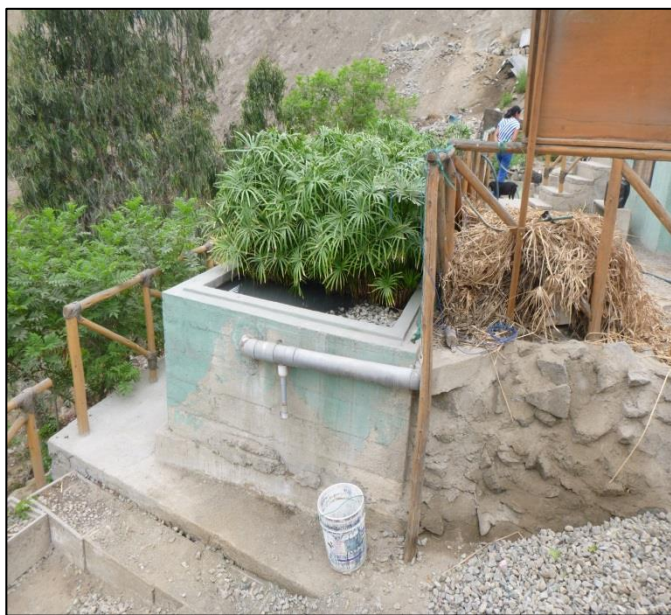
Anexo 1.11: Zona de entrada del agua gris al humedal, se aprecia tubería con aguas grises provenientes de la trampa de grasa.
