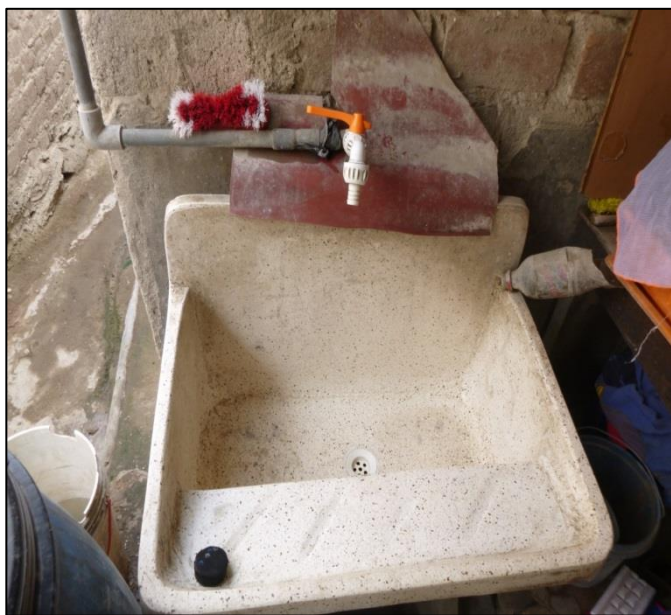
Anexo 1.5: Lavadero multiuso instalados en las viviendas, de material de granito.
