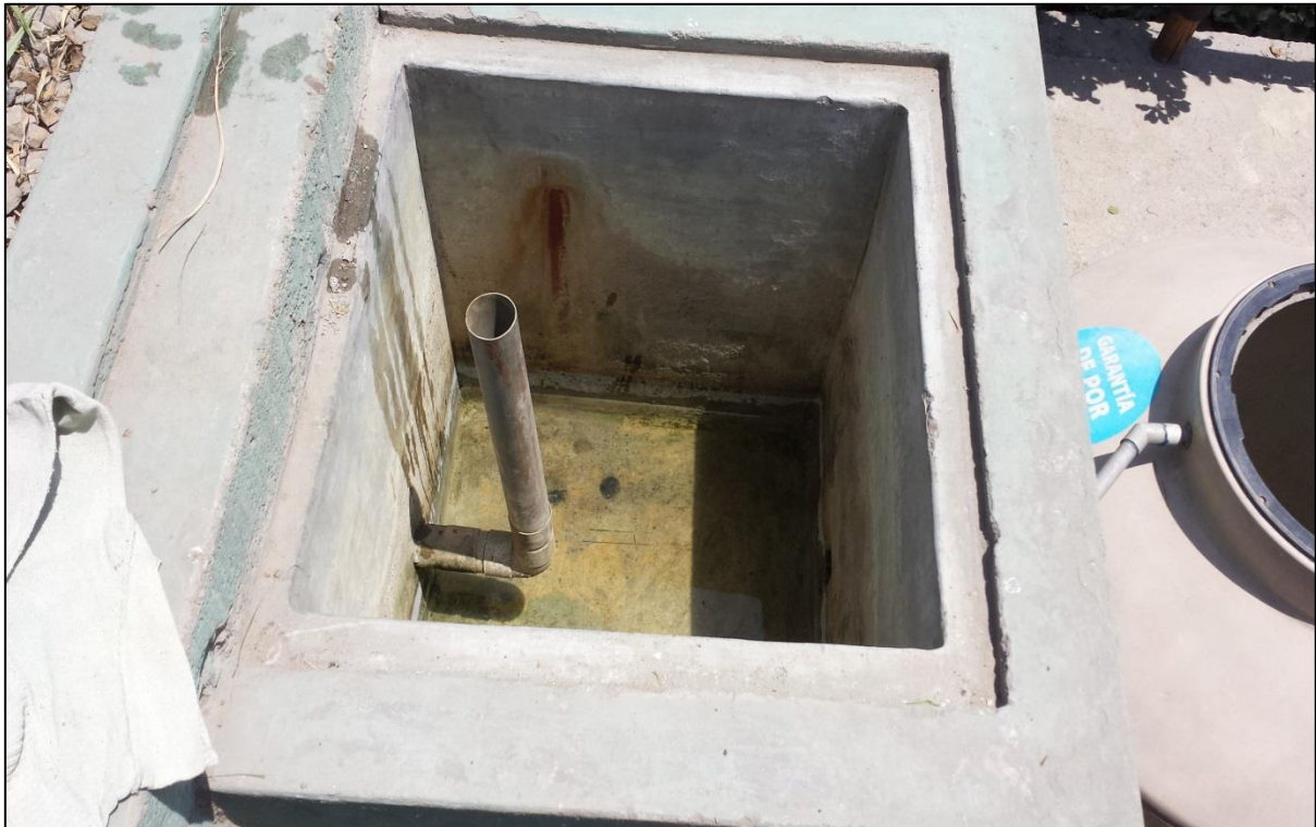
Anexo 1.25: Punto de muestreo P-3 (agua gris tratada), ubicado en la cámara de salida del humedal, también se aprecia tubería perpendicular que regula el nivel de agua en el filtro del humedal.
