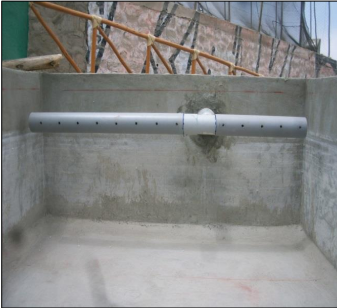
Anexo 1.1: Tubería de distribución del agua gris al ingreso del humedal, se aprecia las perforaciones por donde se distribuye el agua.
