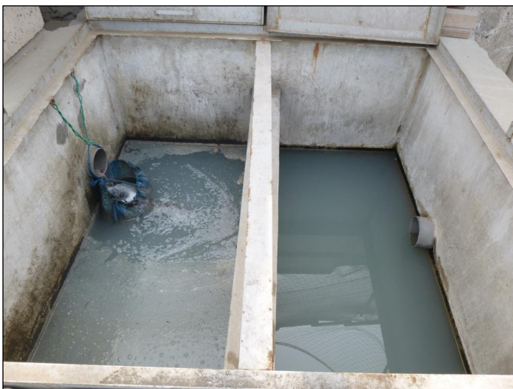
Anexo 1.7: Vista interior de la trampa de grasa, se visualiza diferencia entre el lado izquierdo y derecho producto de la retención de los aceites y grasas.
