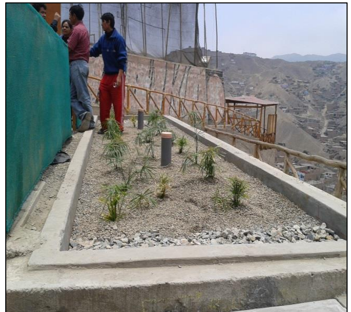
Anexo 1.4: Humedal artificial iniciando su operación en octubre del año 2012.
