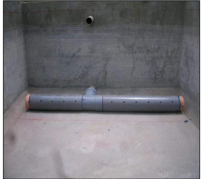
Anexo 1.2: Tubería de recolección del agua gris tratada a la salida del humedal, con perforaciones para la recolección del agua tratada.
