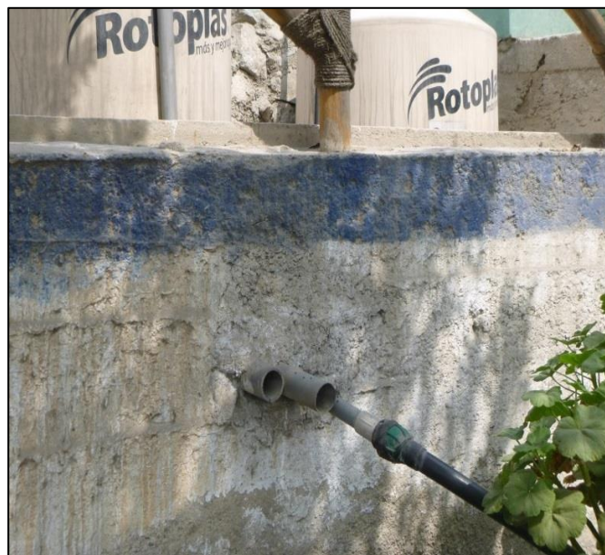
Anexo 1.16: Se visualiza la conexión entre los tanques de almacenamiento y el sistema de riego por goteo. Asimismo, se visualiza dos tuberías libres que sirven para el desfogue de agua en exceso de cada tanque de almacenamiento.
