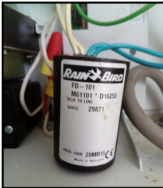
FOTOGRAFÍA N°4: RELÉ ARRANQUE BOMBA – DECODIFICADOR FD-101
