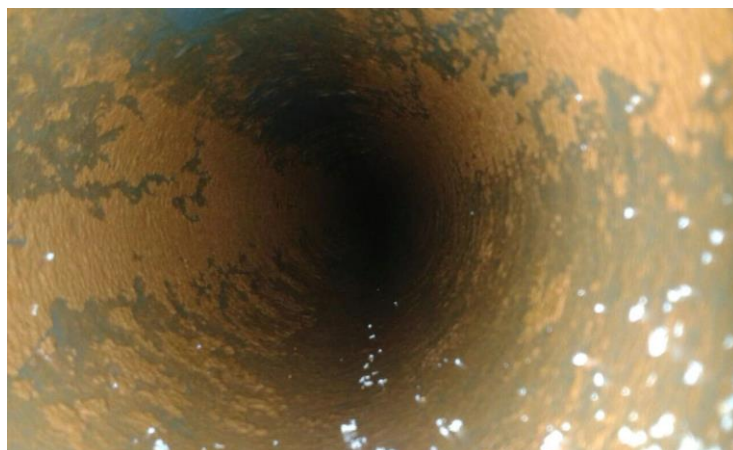
Tubería matriz Ø 140mm. Referencia Puerta N°1
