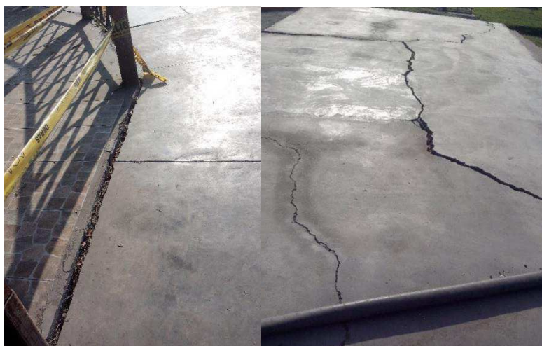
Figura 25: Falla estructural zona patio de comidas (izquierda), grietas veredas (Derecha)
