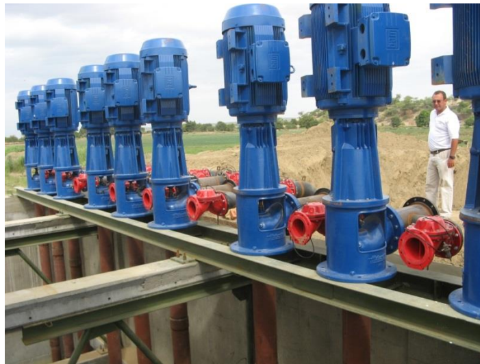
Figura 2: Equipo de bombeo
