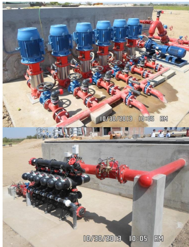
Figura 21. Electrobombas y filtros del sistema de lubricación y desarenado
