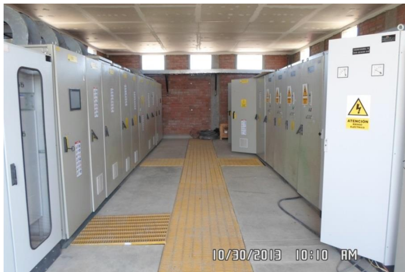
Figura 15. Caseta de control de bombeo
