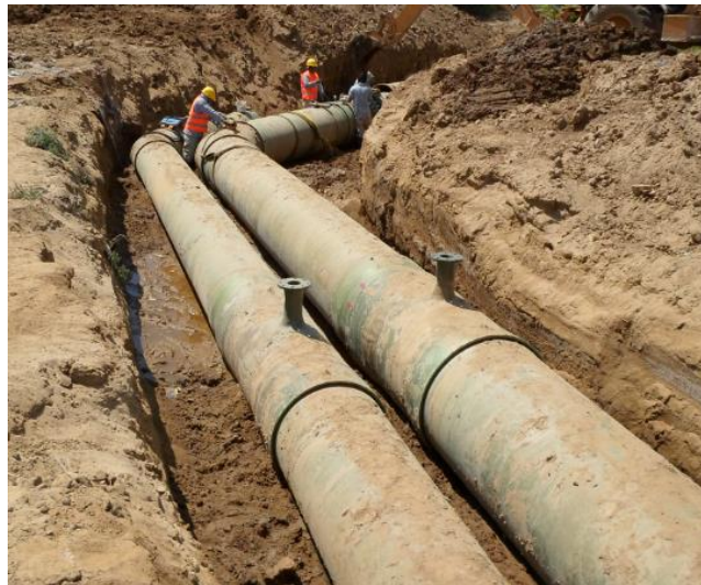
Figura 9. Tees instaladas en las líneas de aducción
