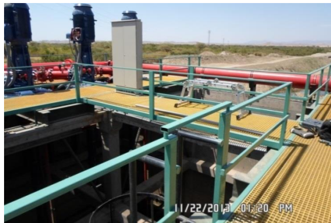
Figura 14. Caminos para la circulación y mantenimiento de las electrobombas
