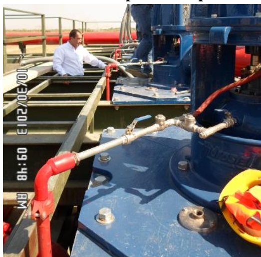
Figura 22. Puntos de lubricación en las prensaestopas de las bombas de impulsión
