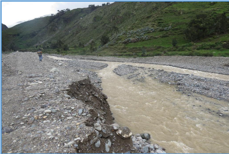
FOTO N°2: Río Gordor en el centro poblado Gorgor, donde se observa la pérdida de material en las laderas del río producto de la erosión.
