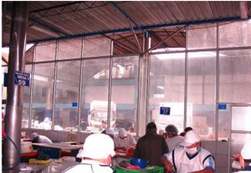
Figura 13: Aberturas en las uniones del techo y pared
