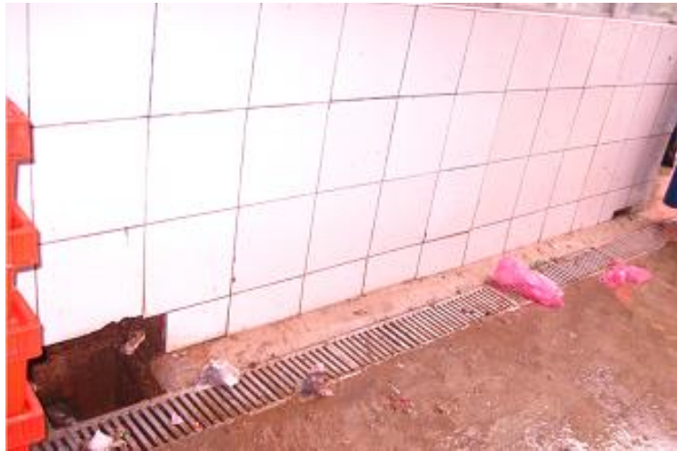
Figura 15: Falta de sellado de la junta pared-piso
