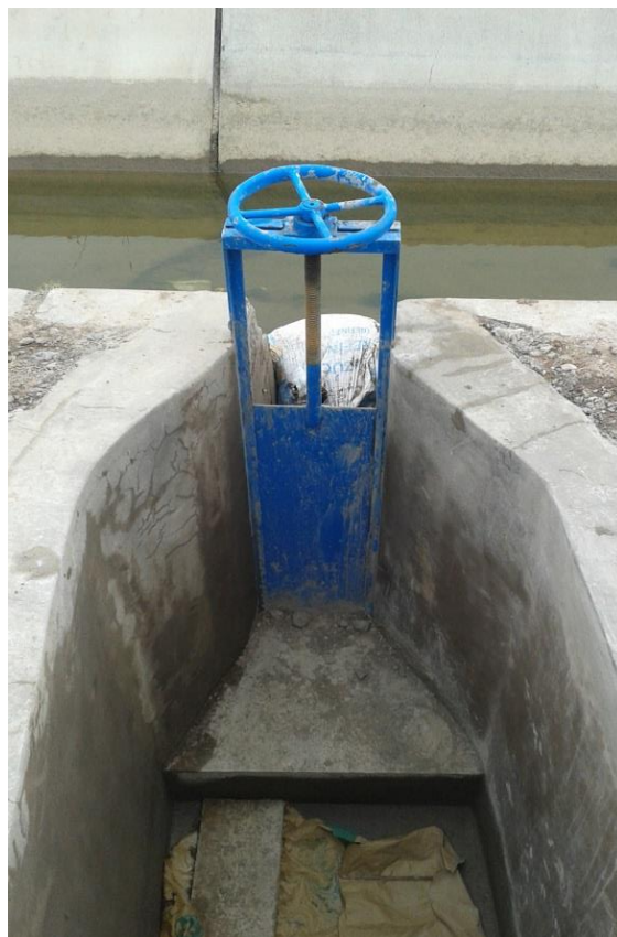
Figura 21: Toma de captación (SISRIEGO S.R.L, 2015)
