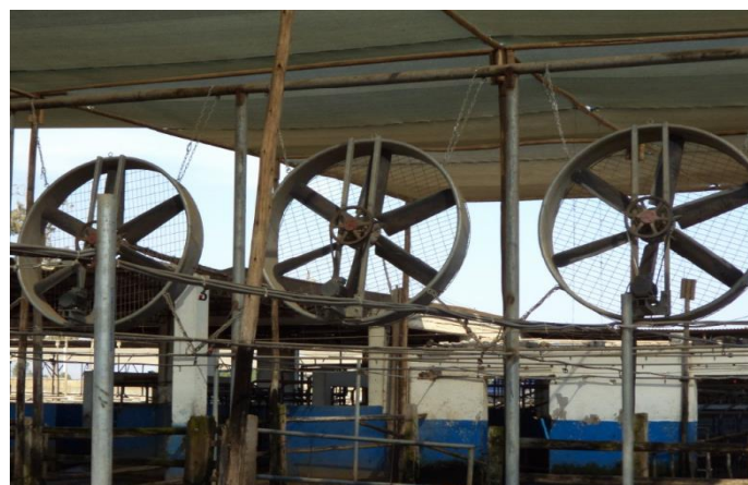
Figura 12. Ventiladores en corral de espera
