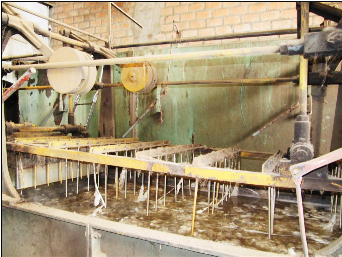
Figura 13 Tina de lavado con sistema de transporte a rastrillera.
