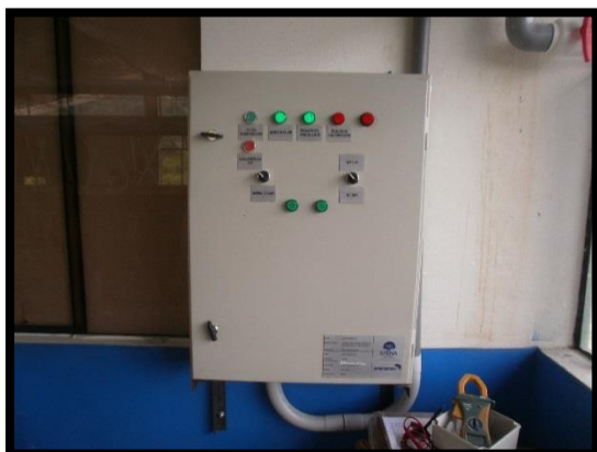
Figura 64: Tablero de control eléctrico instalado en el fundo Palmeiras. (Fuente: Spena Group S.A, división de acuicultura).
