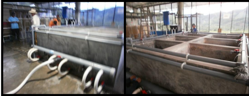
Figura 60: Vista de conexiones en las pozas de cultivo, en el fundo Palmeiras (Spena Group S.A, división de acuicultura).
