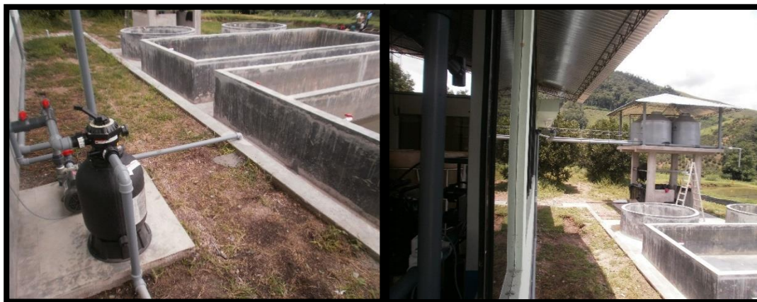
Figura 59: Vista de pozas y filtro de arena, en el fundo Palmeiras (Fuente: Spena Group S.A, división de acuicultura)
