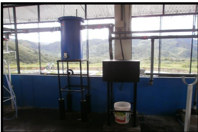
Figura 61: Biofiltro utilizado en el sistema, en el fundo Palmeiras. (Fuente: Spena Group S.A, división de acuicultura).
