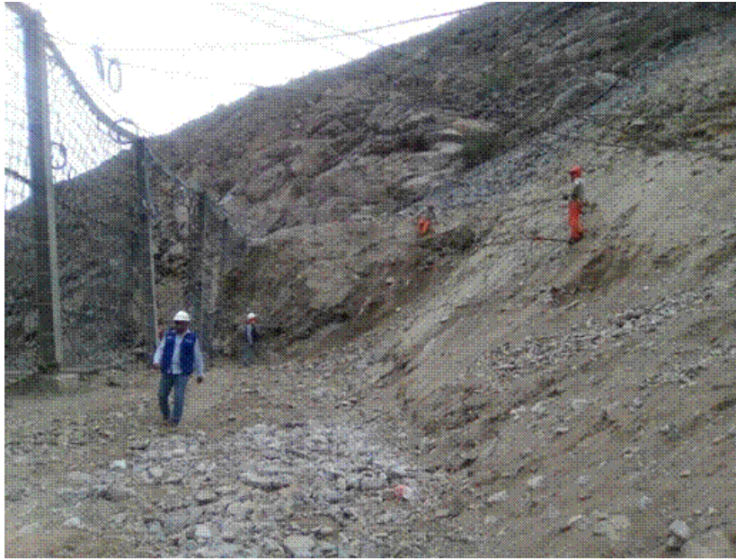
Figura 48: Barrera Dinámica N°10 colmatada al 83% de su capacidad
