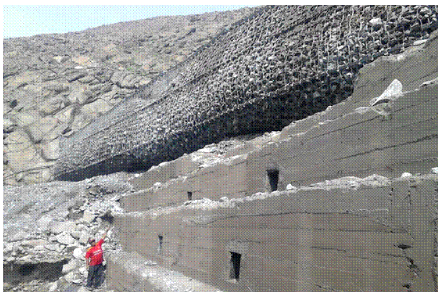
Figura 47: Barrera Dinámica N°10 - Quebrada Carosio
