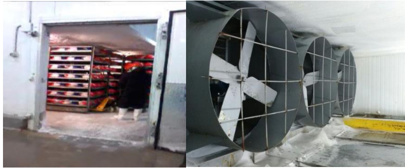
Figura 4: Equipos de congelamiento.
