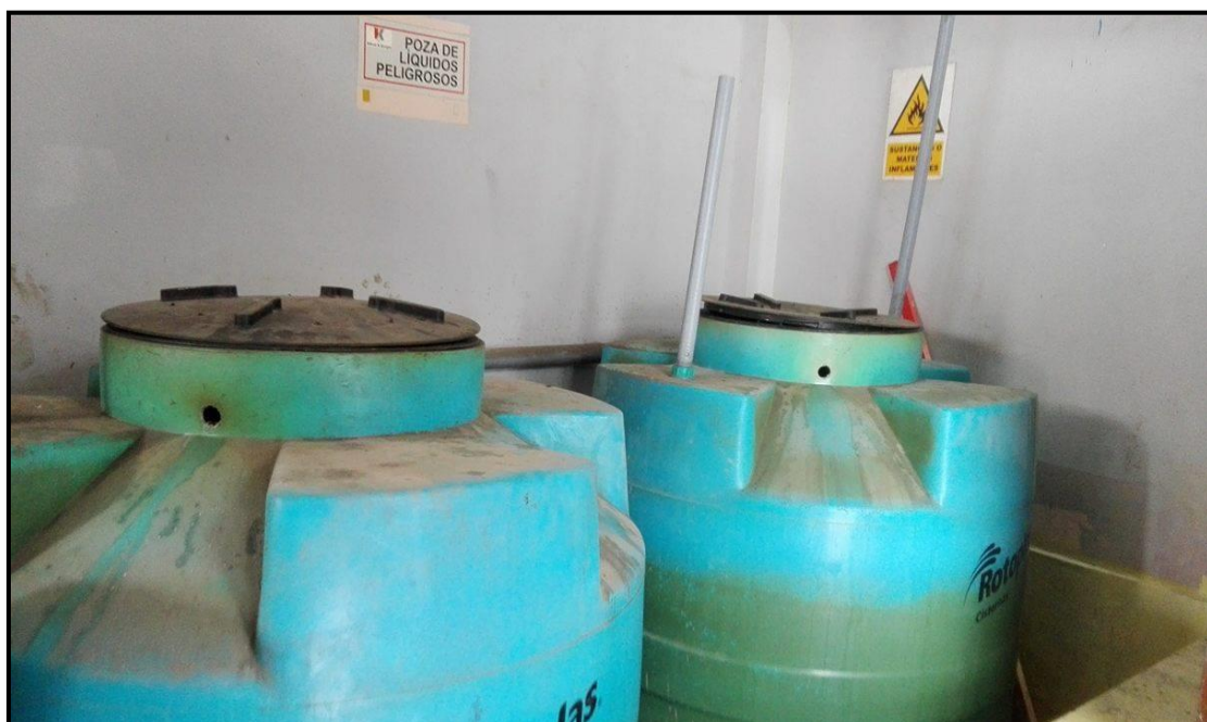
Figura 9: Tanque de almacén de Líquidos Peligrosos
