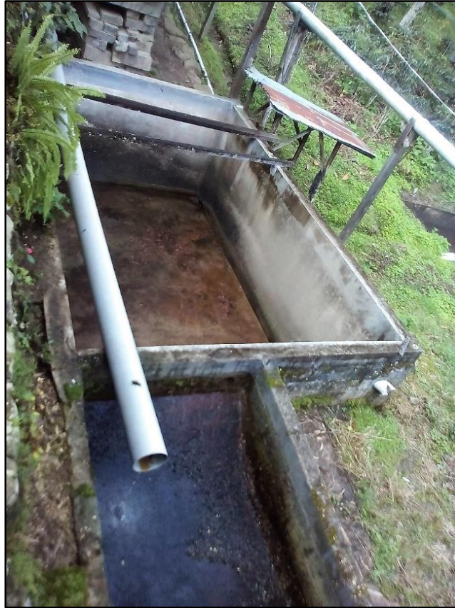
Figura 29: Pozas de sedimentación
