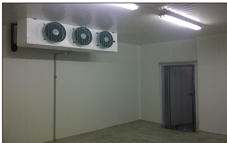
Figura 8: Cámara de refrigeración de la Planta Piloto de Leche
