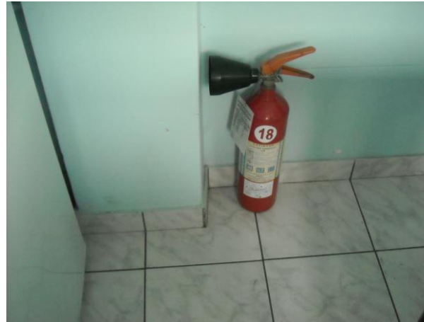
Extintor N° 18 se encuentra en el piso
