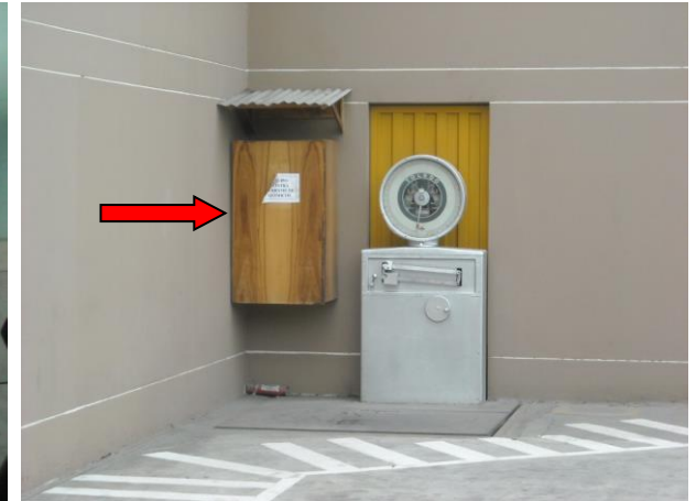
No se ubicó la llave del locker de equipos contra derrames de químicos
