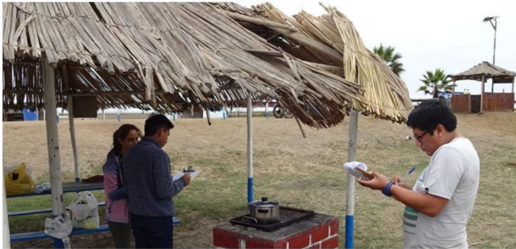
Figura 66: Fotografía del techo de los “hongos”, que evidencia el estado de mantenimiento del sitio del operador turístico público.
