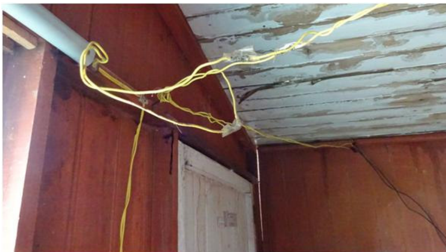
Figura 29: Fotografía del cableado eléctrico en las habitaciones construidas recientemente para el servicio de hospedaje del operador público.
