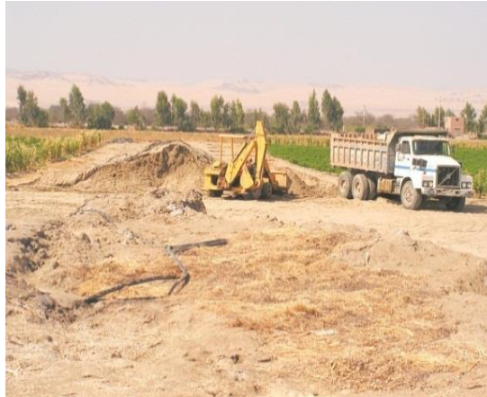
Figura 5: retiro de sales al límite del predio
