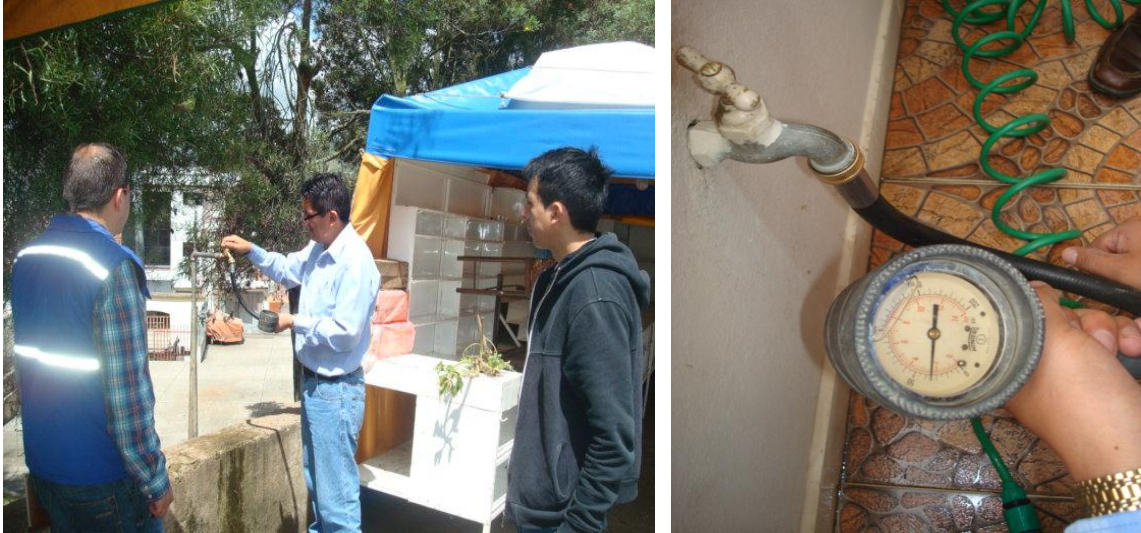
Figura 15: Medición de la presión en campo usando un manómetro portátil
