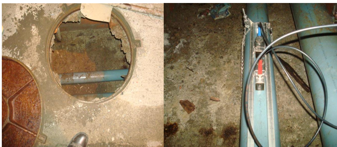
Figura 34: Estación 1 de medición de caudal ubicada en la calle Miguel Heredia (imagen izquierda). Sondas del caudalímetro ultrasónico instalado en una tubería de PVC de 110 mm (imagen derecha)
