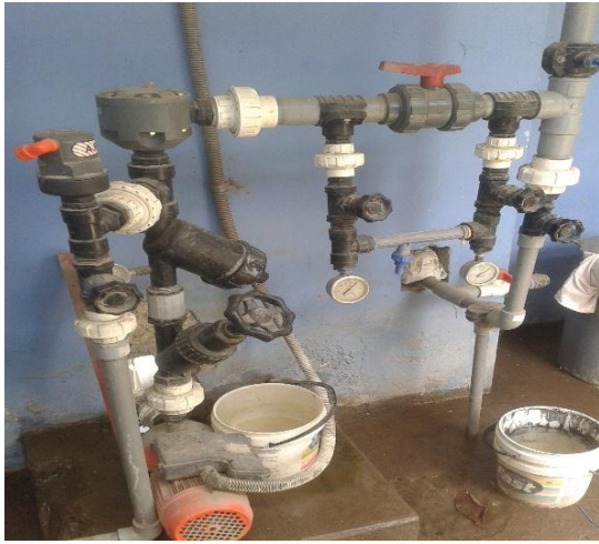
a) Cabezal de riego existente
