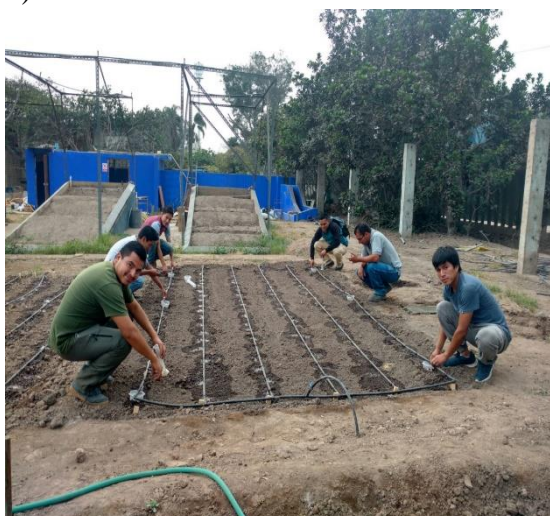
f) Prueba de coeficiente de uniformidad
