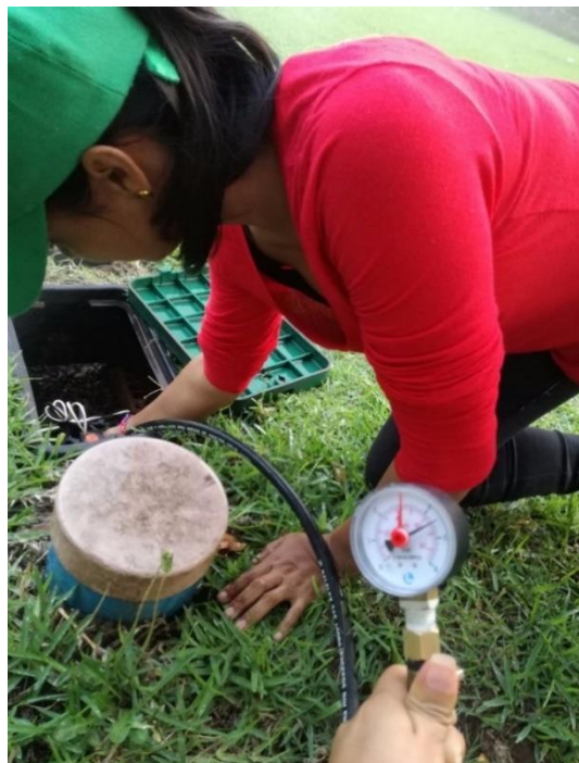
Figura 64: Medida de presión en la salida del arco de riego
