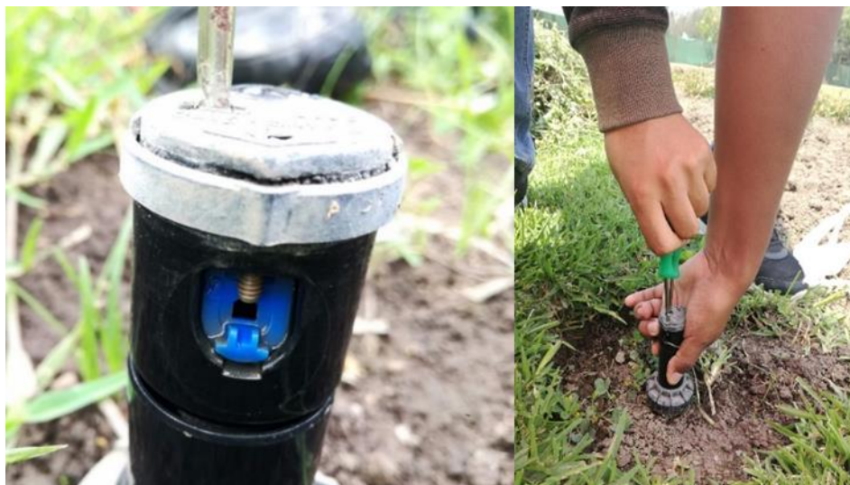
Figura 60: Ubicación y limpieza de rotores
