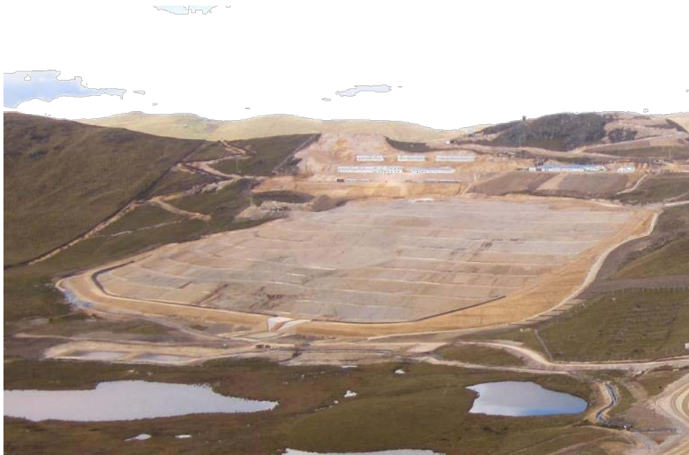
Figura 16: Depósito de Material Inadecuado
