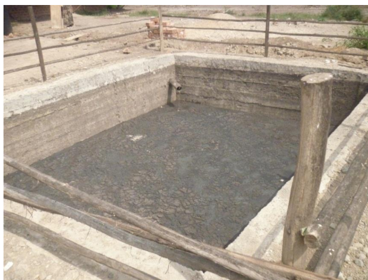
Figura 2. Poza de almacenamiento del estiércol porcino.
