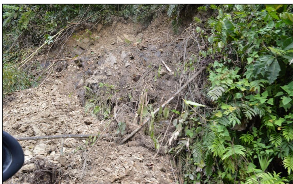
Figura 75: Deslizamientos ocurridos en el tramo Coloradito-Pelayo
