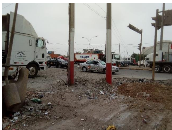
Pistas y veredas en mal estado en la Av. Néstor Gambeta.
