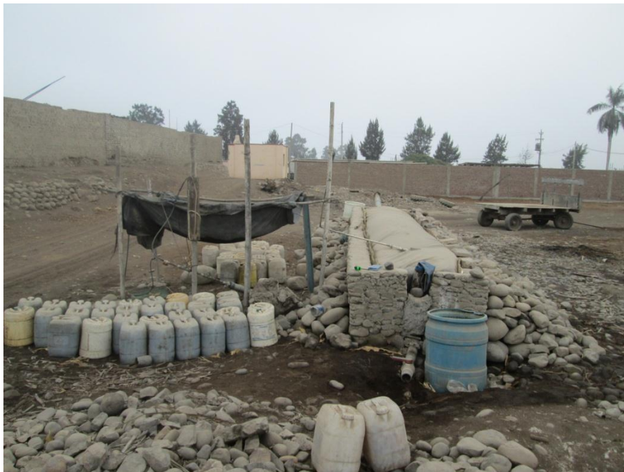
Fotografía 2: Condición que se encontró el Biodigestor anaeróbico
