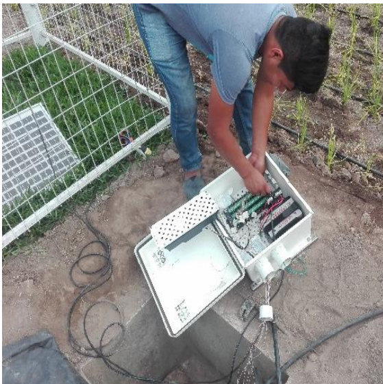
Instalación de STT, panel solar y sensor de humedad y temperatura del aire al data logger.
