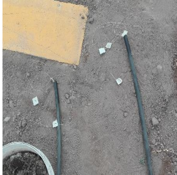
Identificación de sensores térmicos de termocuplas y protección con manguera.
