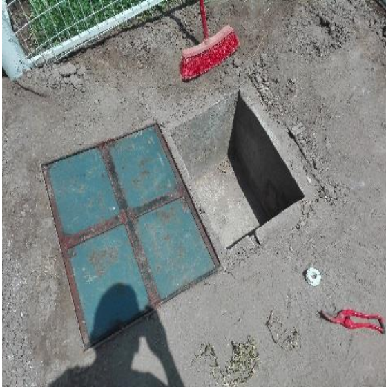
Cámara de concreto y tapa metálica en el área de ubicación del data logger.
