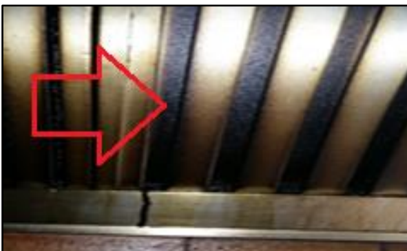
Figura 8: Rejillas de campana con grasa.
