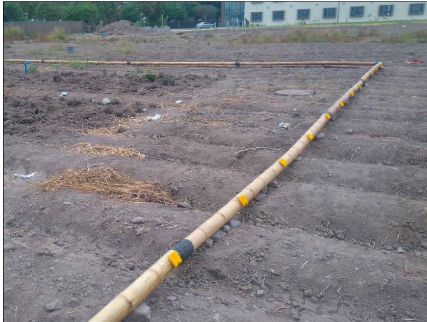
Tubería de conducción de bambú.
