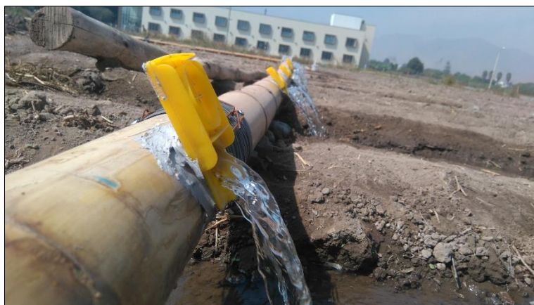
Figura 10: Tubería de conducción de bambú.
