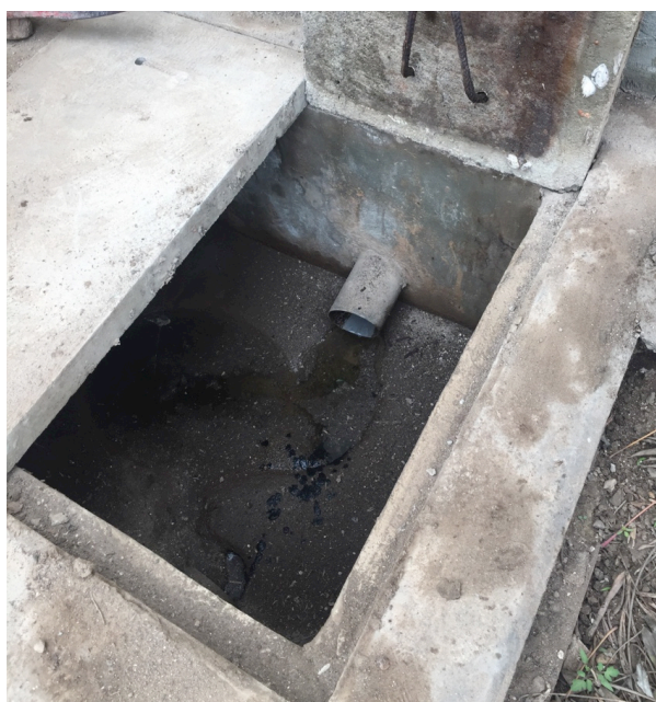
Figura 1: Caja de alcantarillado con trampa de sedimentos colmatada.
