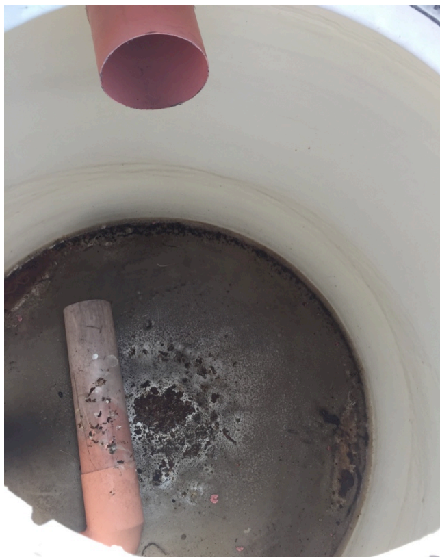
Figura 35: Interior de scrubber (área 2).
