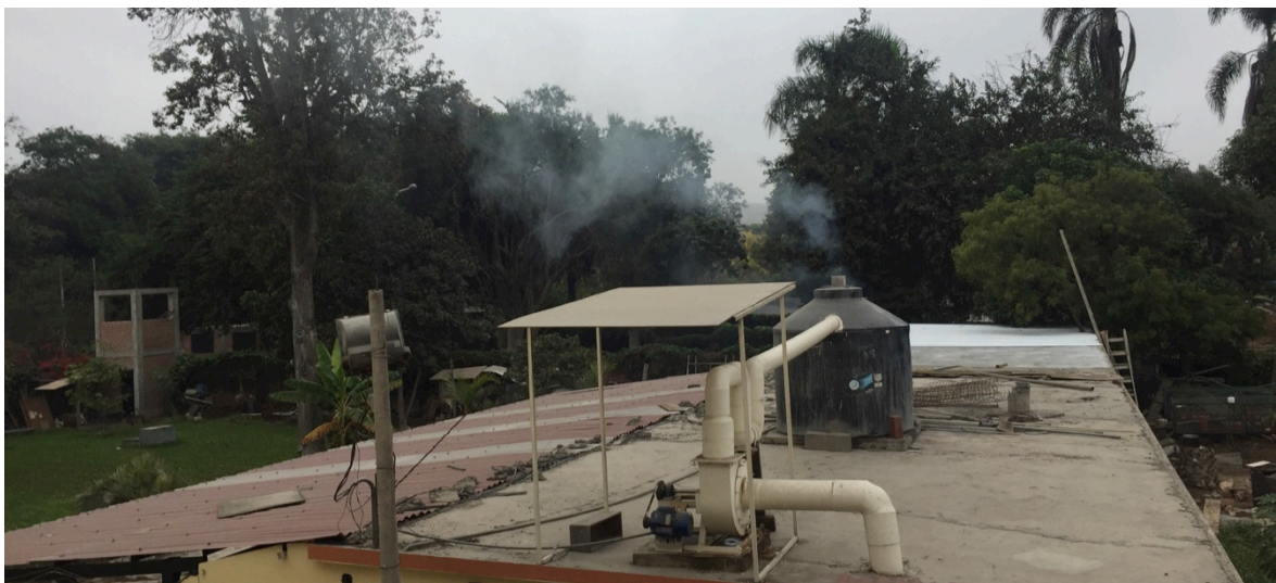
Figura 3: Chimenea del punto c1 con scrubber en desuso.
